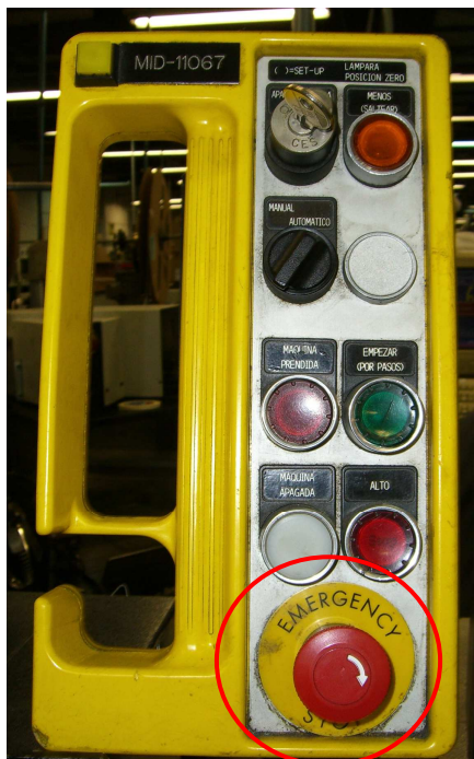
Figura 24 – Botão de emergência do painel de comando da Megomat 3001 Fonte: Arquivo pessoal, 2011
